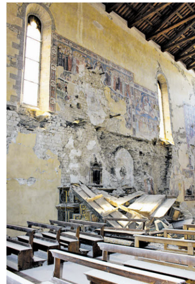
Die Basilika San Francesco in Amatrice wurde vom Erdbeben stark beschädigt. BILD: SN/AP
